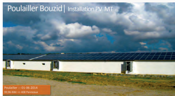
Figure 14. Utilisation de l'énergie solaire photovoltaïque pour l'autoproduction de l'électricité raccordée au réseau MT, poulailler « BOUZID », Korba, Nabeul (Gamco) avec une capacité de 100 KWc 46
