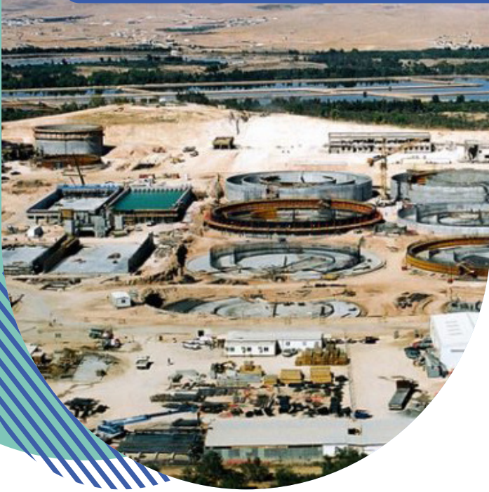
محطة السمرا لمعالجة مياه الصرف الصحي في الأردن. المصدر: WSSH: Middle East, Jordan 2009, Flickr
